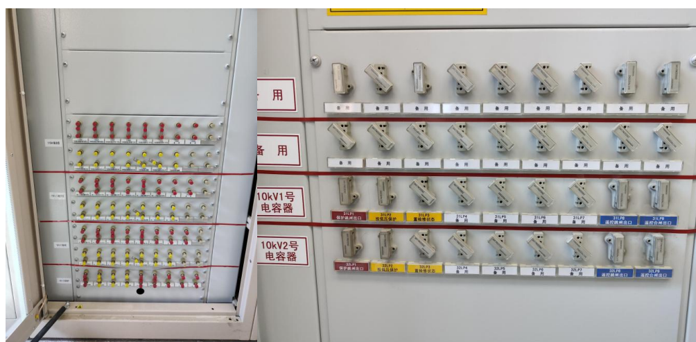
(a) 常见的控制柜压板图片
