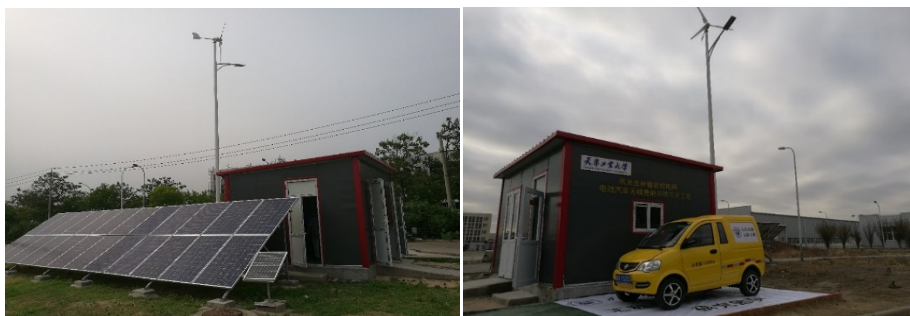
Figure 10. Demonstration project external platform 图 10. 示范工程外部平台
