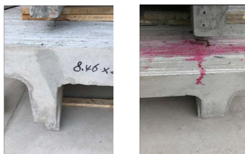
(a) 内腋角裂缝
