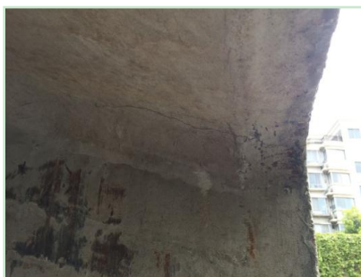
(c) 底部裂缝
